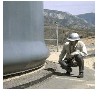
Plaatje 2 Opslagtank met elephant foot buckling, USA
