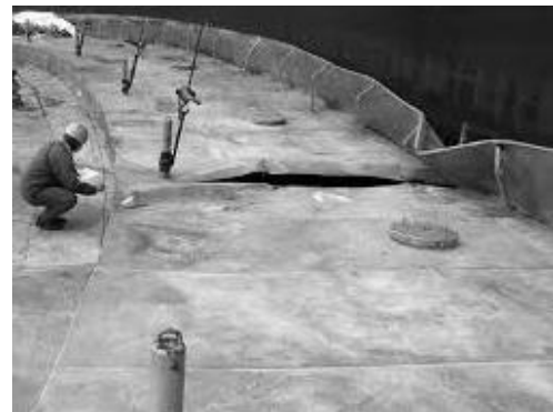
Plaatje 1 Beschadigde opslagtank door sloshing, 2003 Tokachi-Oki aardbeving
