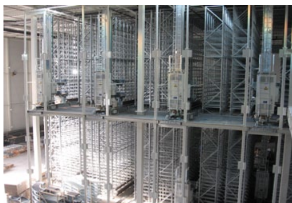
Bouwfase van een tussenvloer in meerdere etages en in combinatie met stellingen.
